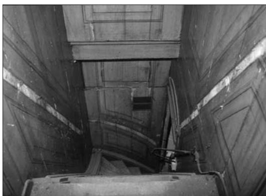
Afb. 3. Vismarkt 37, wandafwerking op zolder, 19de-eeuwse imitatie-grenenhouten beschildering met panelen en lijsten. Foto: A. de Goojer, afd. Bouwtoezicht en Monumenten (B&M).
