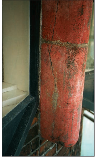
Afb. 10. Ged. Zuiderdiep 96, detail raamdeel met scheurvorming.
