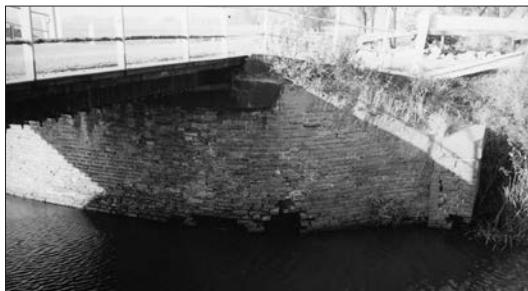
Afb. 2. (boven) Aduarderdiepsterweg, scheuren en gaten in een van de landhoofden. Foto: gemeente Groningen.
