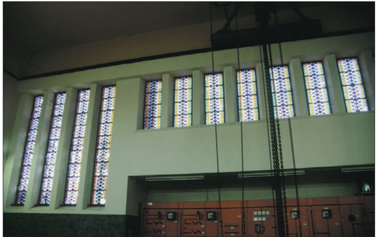
Afb. 3. Hoofdrioolgemaal, interieur met glas-in-loodramen. Foto: Dienst RO/EZ.
