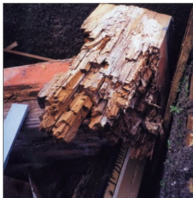
Afb. 13. Legeweg 38, verrot balkeind van in 1999 verwijderde en aangeheelde balkkop. Foto: Berend Raangs.
