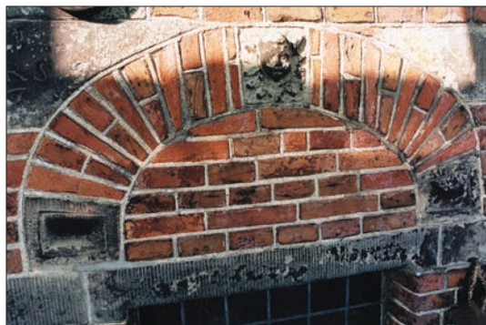
Afb. 11. Oude Boteringestraat 36-38, een slordig gemaakte ontlastingsboog boven een venster. Foto: Taco Tel.
