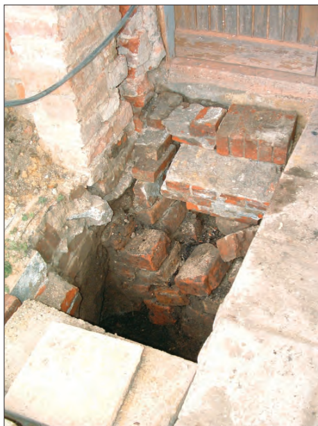
Afb. 11. Engelberterweg 39-41, de gebroken fundering onder de linkerzijde van de ingang in de westgevel. Foto: Anko Wieringa.
