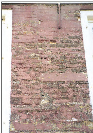
Afb. 14a. Gelkingestraat 20, detailopname van de voorgevel, een penant met rechts van de verticale naad origineel muurwerk. Foto: Taco Tel.
