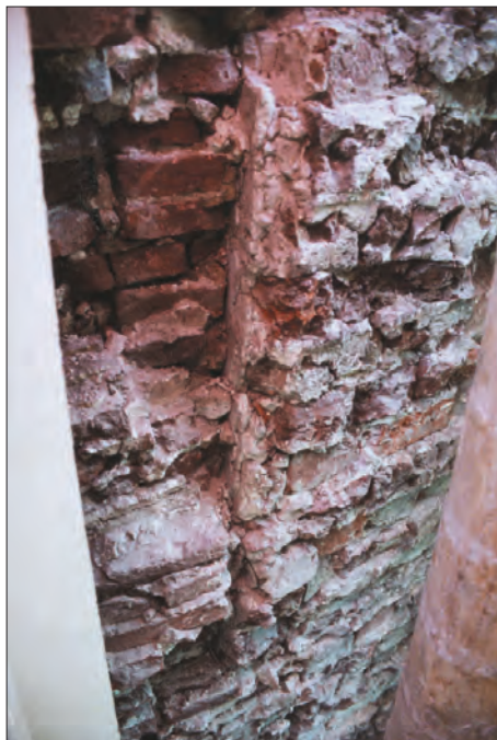
Afb. 42. Turftorenstraat 7, detail dagkant van een oorspronkelijk venster. Foto: Marcel Verkerk, collectie Dienst RO/EZ.
