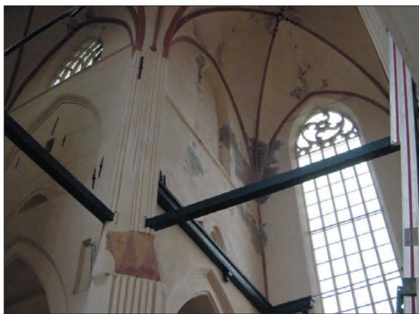
Afb. 3. Der Aa-kerk, pleisterproblematiek vóór de herstelwerkzaamheden in 2006. Foto: OVT architecten, Groningen.
