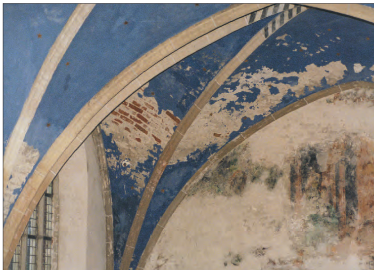
Afb. 10. Martinikerk, stucwerkproblemen op het gewelf van het hoogkoor, 2003.
