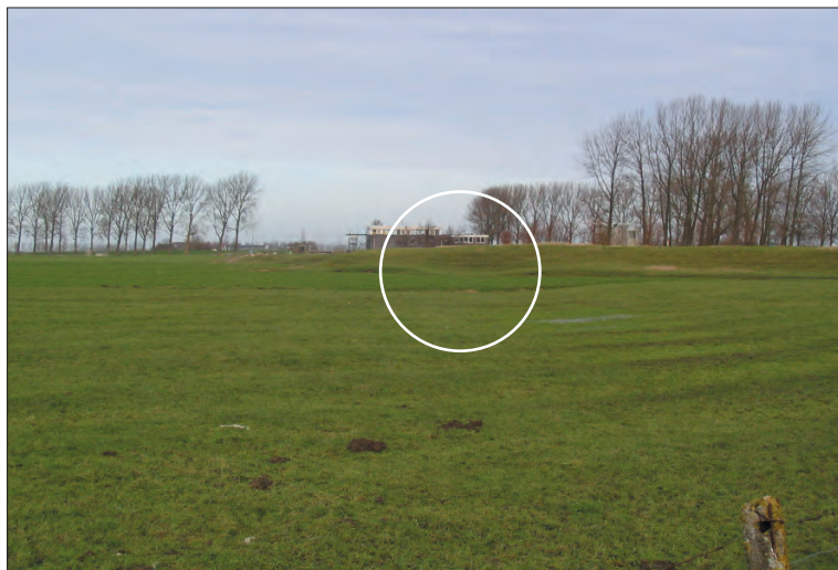
Afb. 12. Verzakke dijkvoet ten zuiden van de Dorkwerdersluis, winter 2006/2007. Foto: Jan van den Broek.
