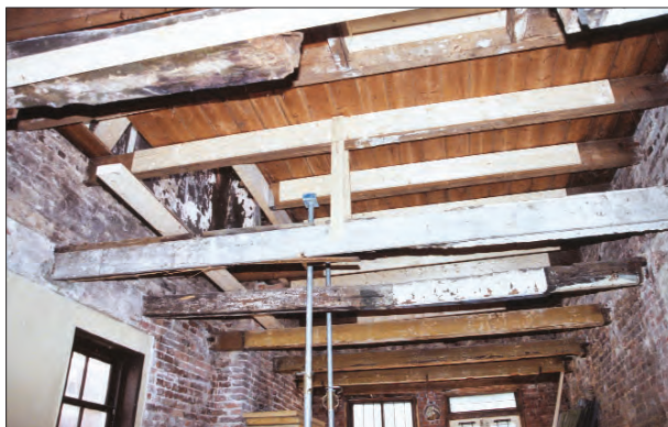
Afb. 21. Vismarkt 10, de vroegere zolderbalklaag die als een loze balklaag onder de tweede verdieping hangt.
