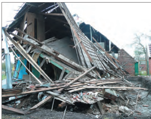
Afb. 23. Pop Dijkemaweg 98 na instorting in 2009. Op de voorgrond en rechts de illegale ontgraving van de fundering waarbij het voorhuis is ingestort.
